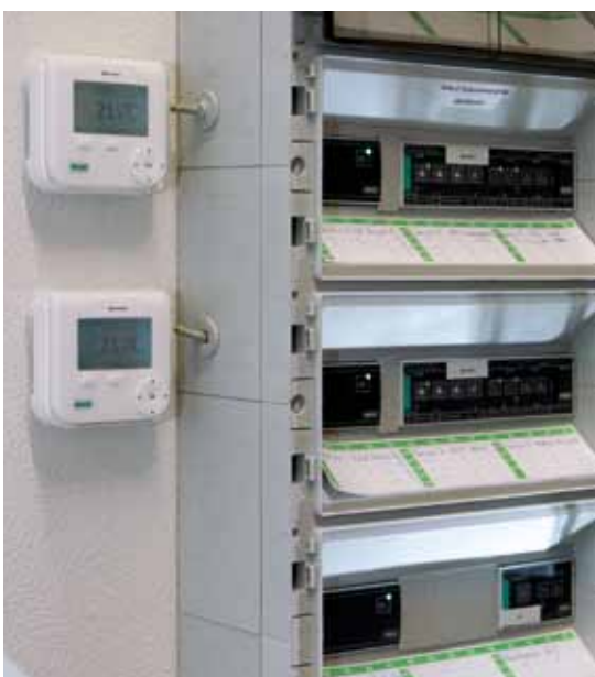
▲ Zwei Server zur Regelung des Systems sind über eine 0-10 V-Schnittstelle mit dem Wärmeerzeuger verbunden, der die Vorlauftemperatur nach den Wärmeanforderungen regelt.
